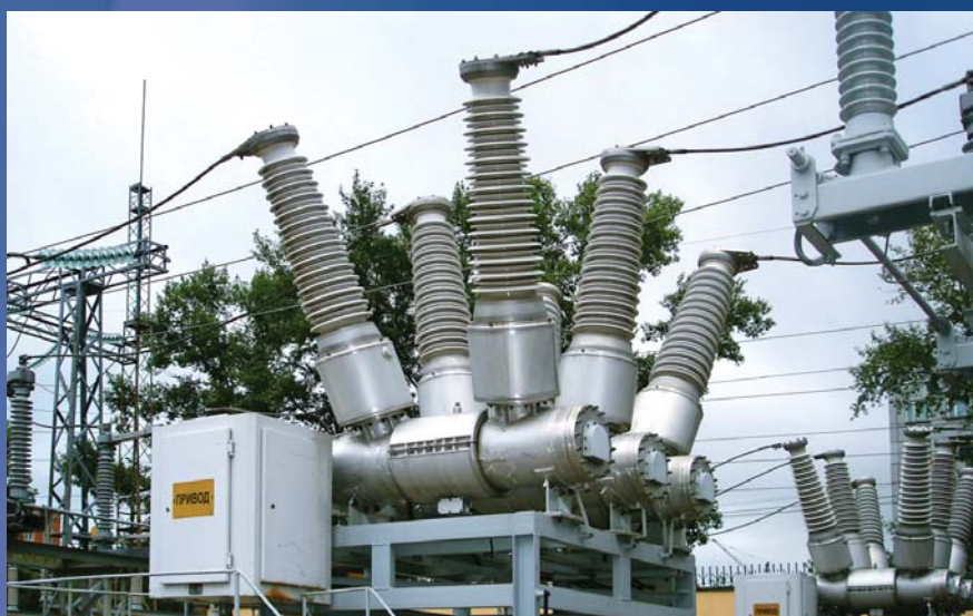
ВЭБ-110 на подстанции «Мальшевская», г. Екатеринбург
