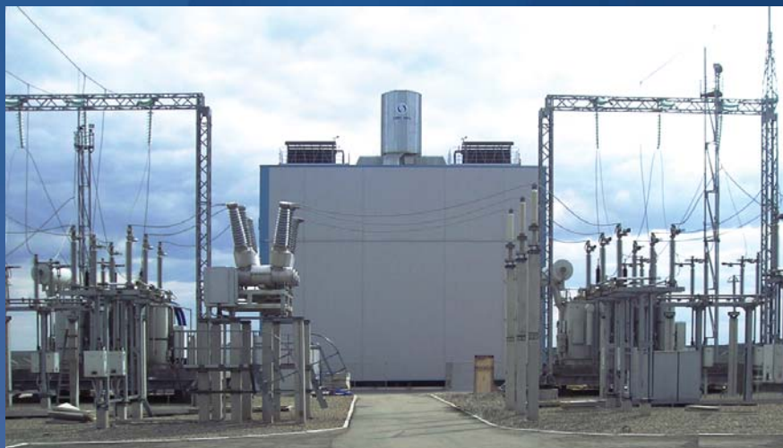
ВЭБ-110 подстанции ГТ ТЭЦ (Республика Калмыкия)
