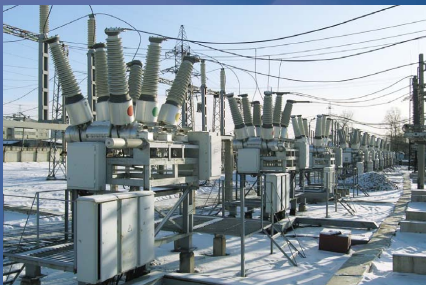
ВЭБ-110 на подстанции «Центральная», г. Благовещенск (Амурская область)
