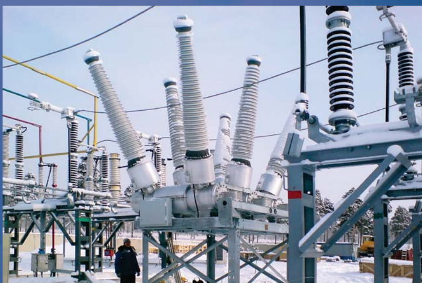
ВЭБ-220 на подстанции «Уренгой», г. Новый Уренгой
