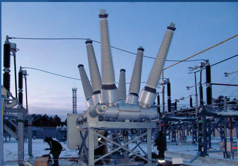
ВЭБ-220 на подстанции «Северная», г. Улан-Удэ
