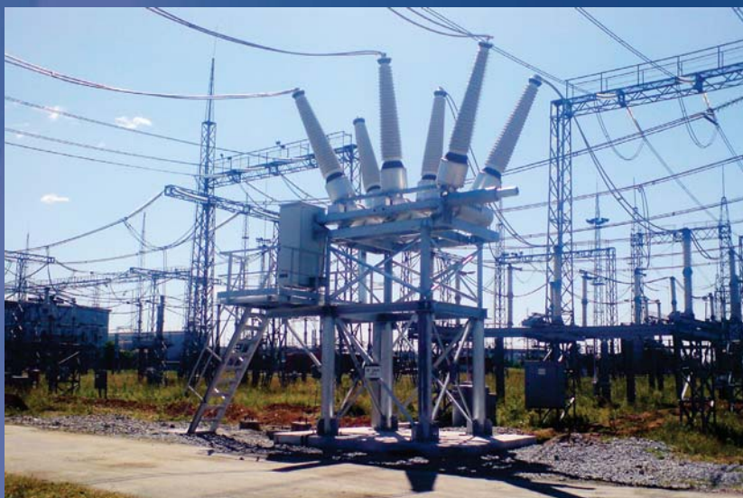
ВЭБ-220 на подстанции «Южная», г. Екатеринбург
